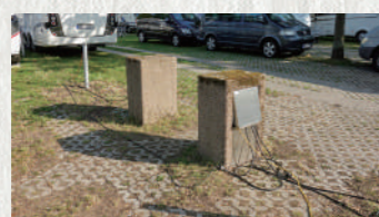
電源ポートも各所に完備されている
